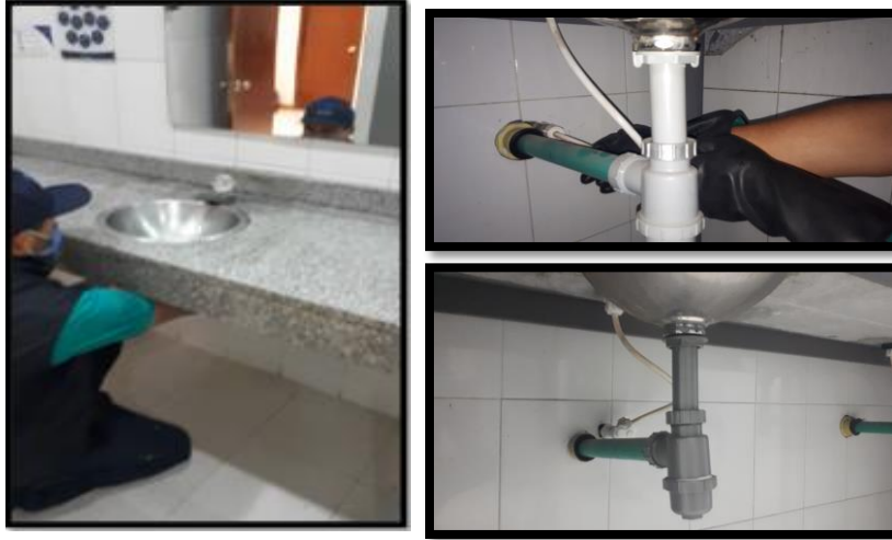
FOTOGRAFÍA 3. VERIFICACIÓN DE ACOPLER AHORRADORES DE AGUA
